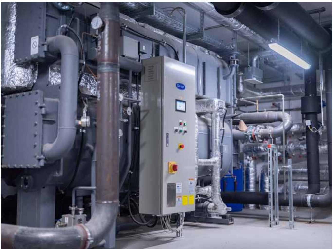
Die Absorptionskälteanlage (AKM) im Raum über dem BHKW ist für den Wärmetausch verantwortlich. Eine AKM nutzt Wärme, um Kältemittel aus einer Lösung auszutreiben, das dann verdampft wird und Kälte erzeugt, bevor es wieder absorbiert wird.
