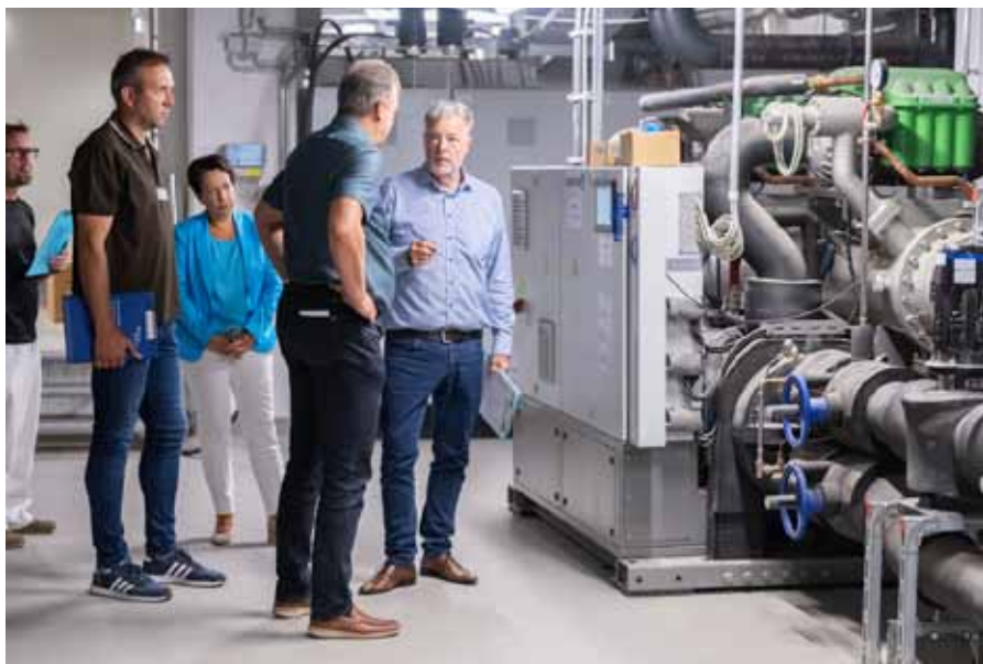
Im Bereich der Technik eines großen Krankenhauses wie dem Klinikum Kulmbach kann viel für die Umwelt getan werden. Deswegen wird dieser Bereich auch regelmäßig genau unter die Lupe genommen.
